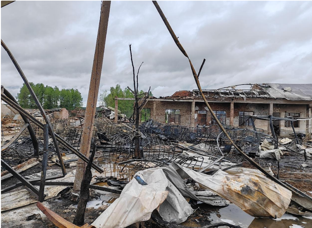
图 5 事故厂房内北侧区域爆炸后情况（自南向北）
