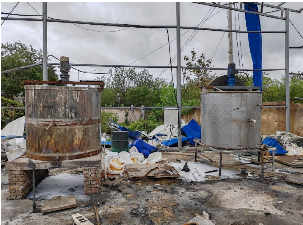
图 4 事故厂房内南侧区域爆炸后情况（自北向南）
