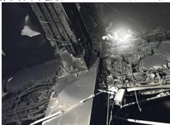
图8 受到严重破损的梁柱
