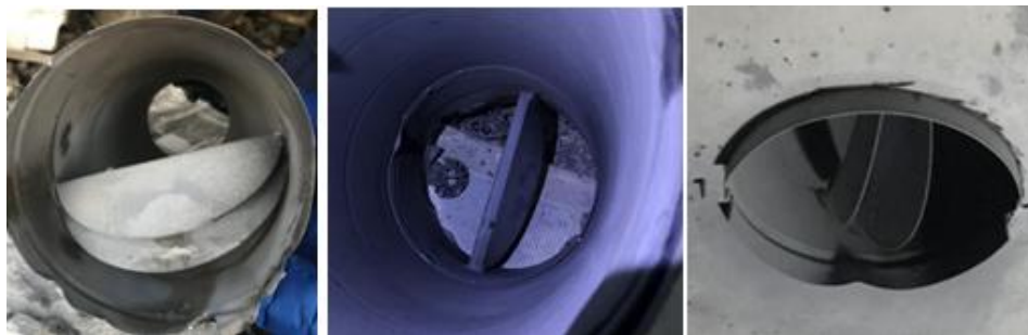
图9 支管内风阀叶片大部分呈现倒向设备的变形
