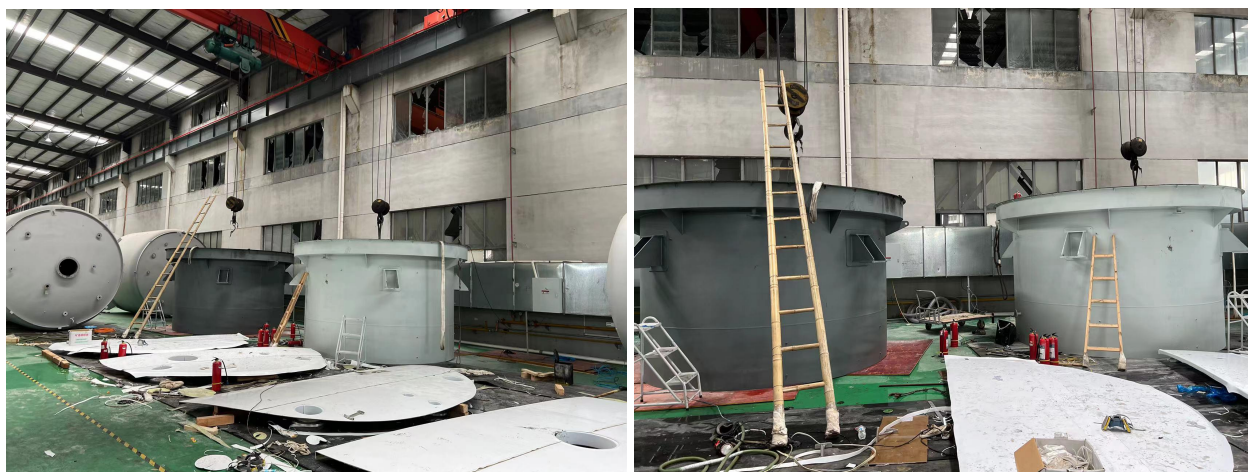
图 3 事故现场照片
