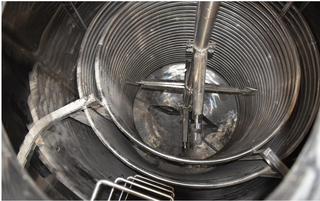
图 6 事故反应釜内部
