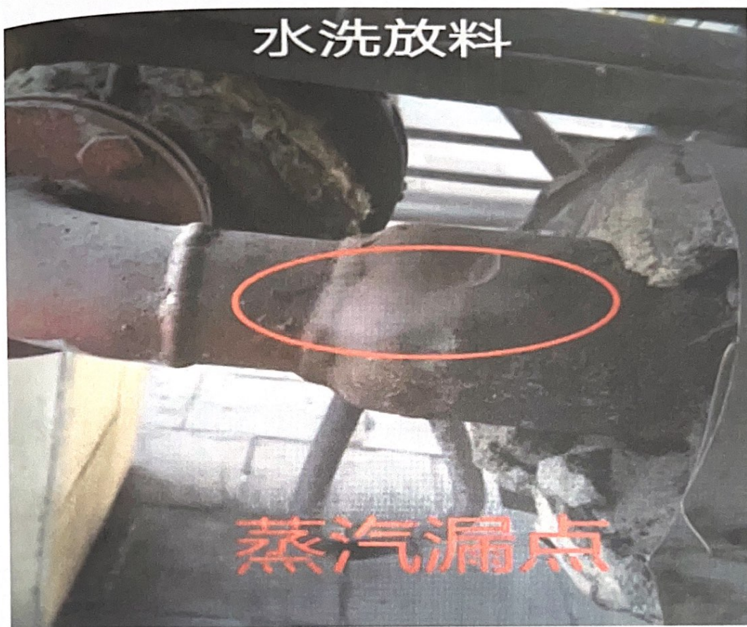
图 1 蒸汽漏点图片
