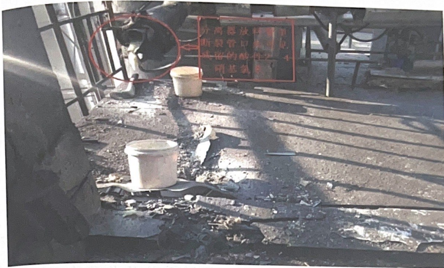
图 5 分离器放料管道断裂管口处可见二硝残留物
