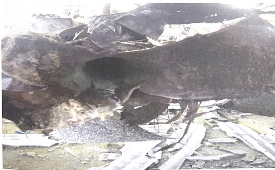
图 2 放料管道撕裂变形
