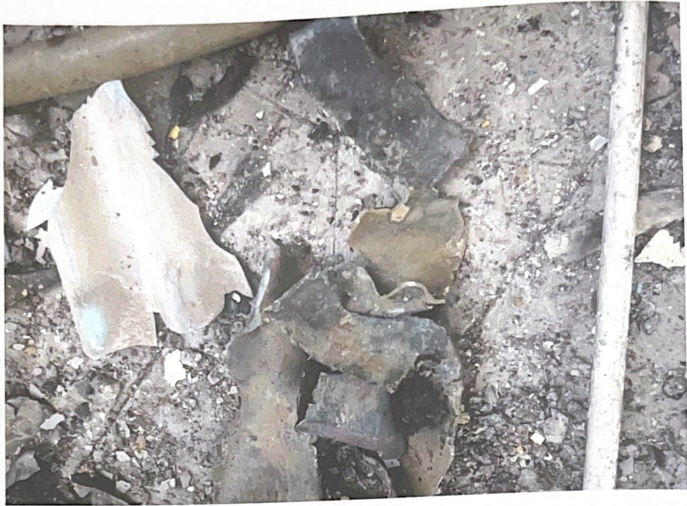
图 3 部分管道粉碎性破裂
