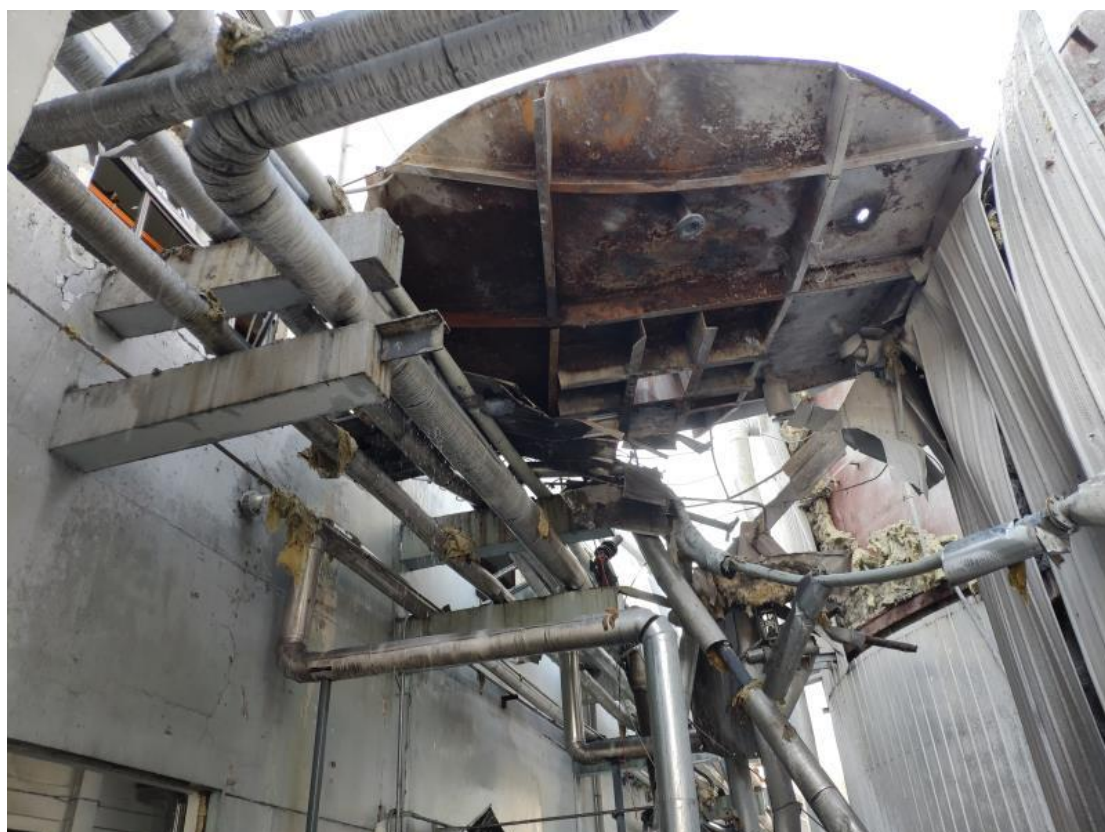
图 7 事故后现场图片
