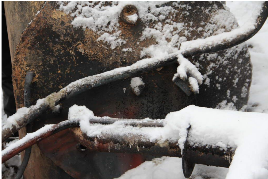
图 2 事故装置损毁情况
