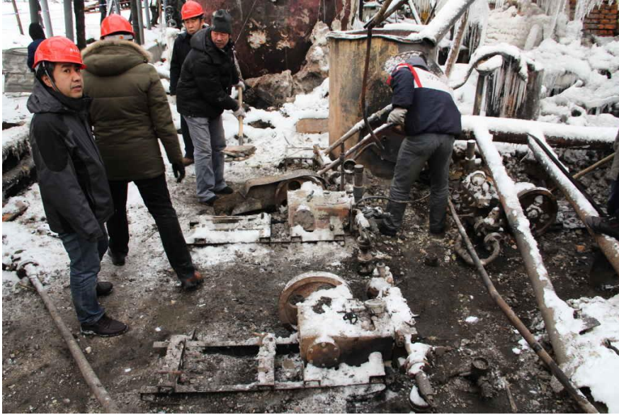
图 1 事故现场损毁情况
